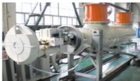
图 3 HDA-3B 液压机构配 ZF15-363 型 GIS 用断路器试验 Fig. 3 The test of HDA-3B hydraulic operating mechanism with ZF15-363 CB for GIS
